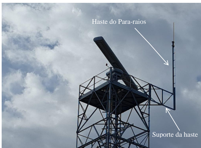
Foto 08: Vista do sistema de fixação do para-raios
