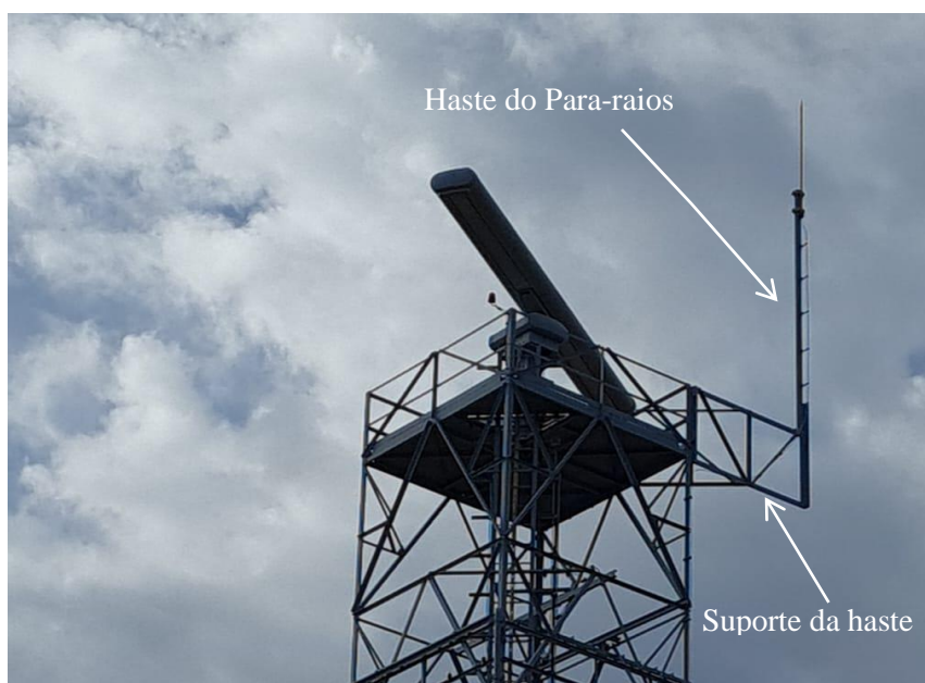
Foto 08: Vista do sistema de fixação do para-raios
