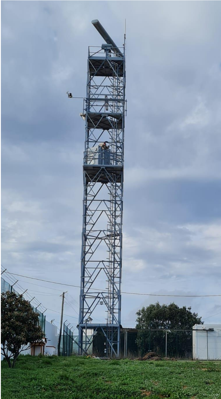
Foto 09 – Torre de 25 metros.
